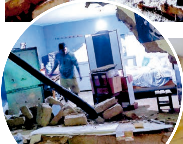
La vivienda que se desplomó en Jaihuayco.
