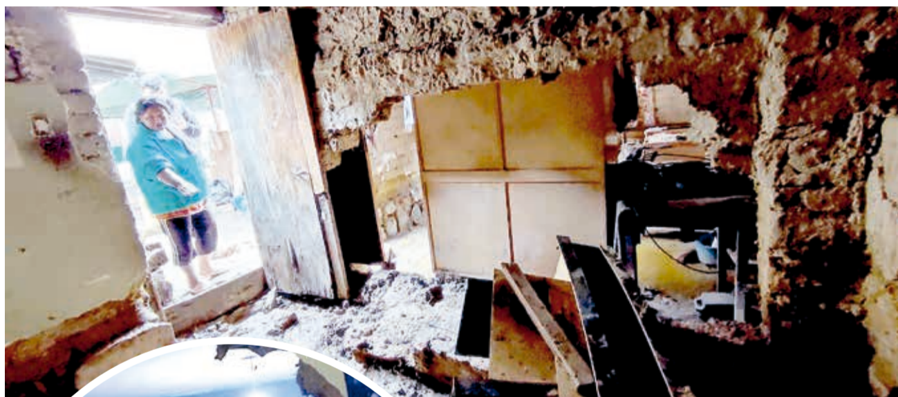
La casa de Dora Cadima que se derrumbó en la Base Aérea.
