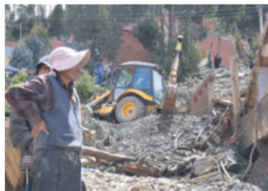
CON MAQUINARIA. El municipio de Achocalla realiza trabajos para ayudar a las familias y arreglar las vías que quedaron intransitables
