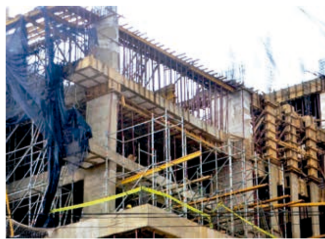
El sector donde se registró el colapso de una losa. D. JAMES
