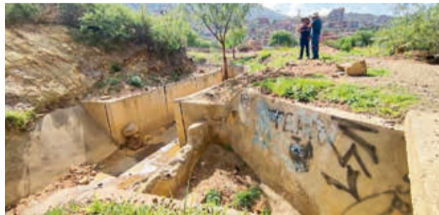
El canal con piedras y desmoronamientos. DANIEL JAMES
