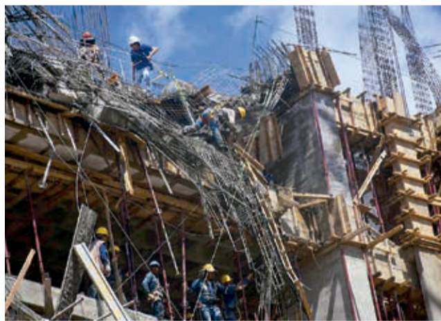
El sector del colapso de la losa del edificio. JOSÉ ROCHA
