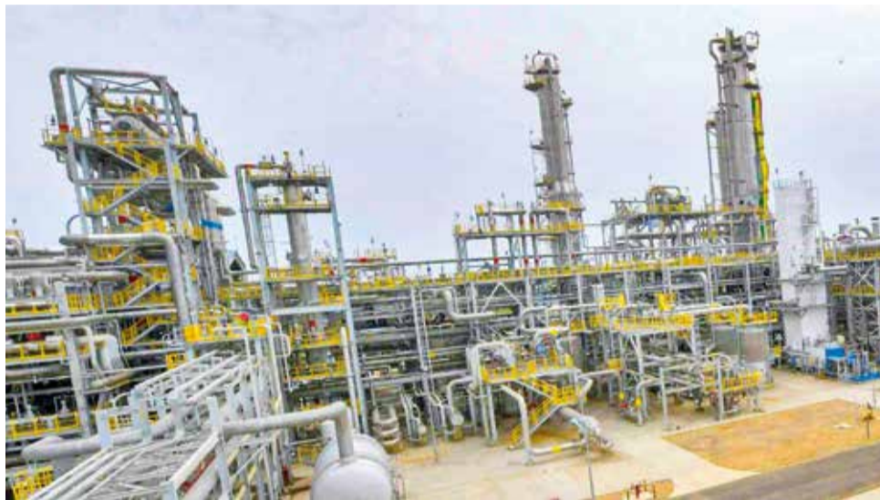
La planta de tratamiento de urea y amoniaco en Bulu Bulu. APG
