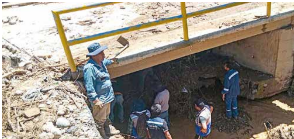
El puente que colapso por la crecida del río Tolavi en Tiquipaya. LOS TIEMPOS
