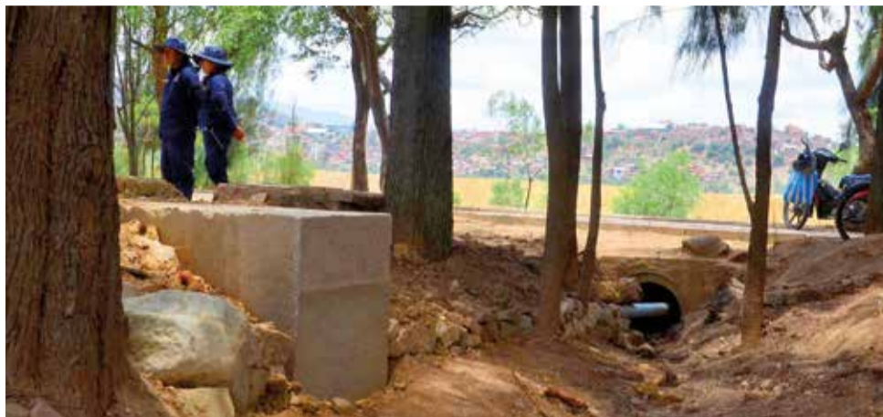
El ducto que permite el ingreso de agua de “lluvias” a la laguna Alalay. HERNÁN ANDÍA
