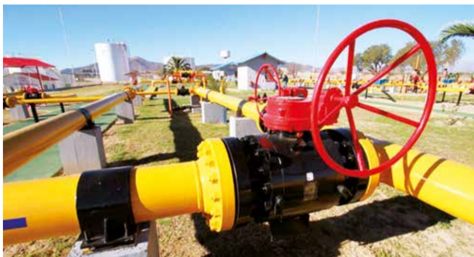
Ductos de exportación de gas. YPFB
