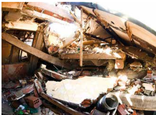
Casas derrumbadas en la zona de Ticti Sur. CARLOS LÓPEZ
