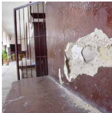
En algunos establecimientos, aún está pendiente el mantenimiento.
