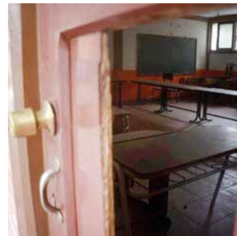
La chapa deteriorada del aula de una escuela en la ciudad.
