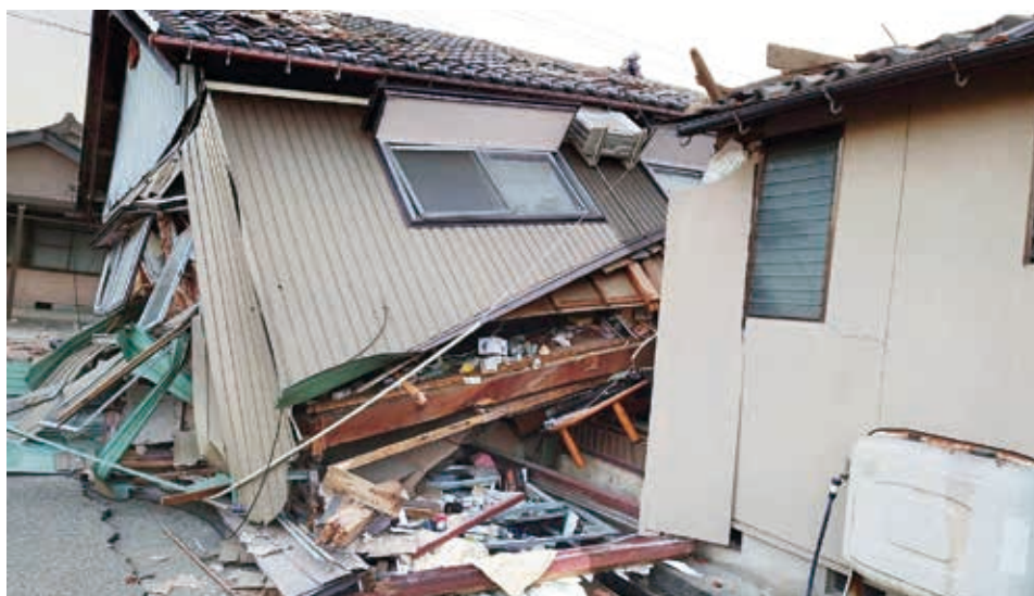
Casas destruidas por el terremoto de ayer, en ciudades de Japón. FOTOS: EFE
