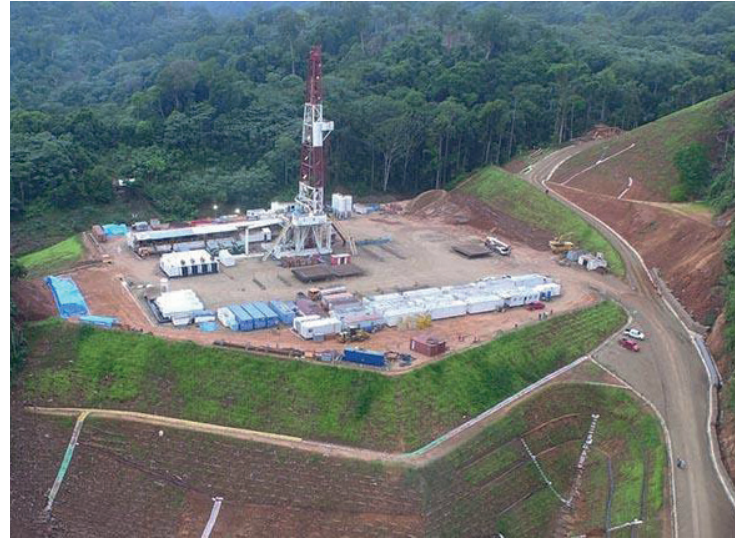
Instalaciones en el pozo Astillero X1, al interior del área protegida /REFERENCIAL
