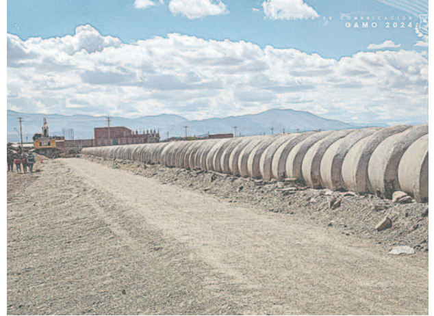
Proyecto de la construcción del Alcantarillado del Casco Viejo beneficiará a todos los distritos /GAMO
