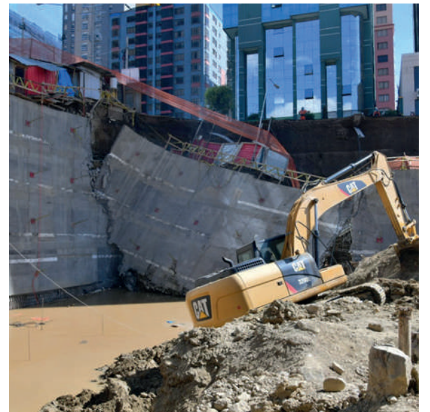
Muro colapsado en la avenida 20 de Octubre en La Paz /AMUN
