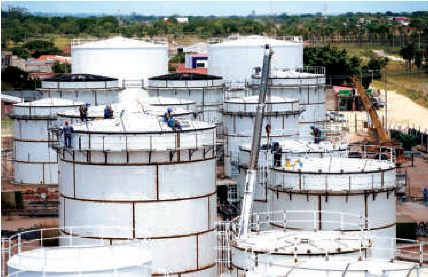
Algunos tanques que componen el complejo.
