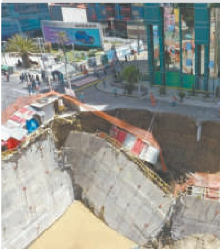
El desplome del muro de contención que afectó a dos avenidas.
