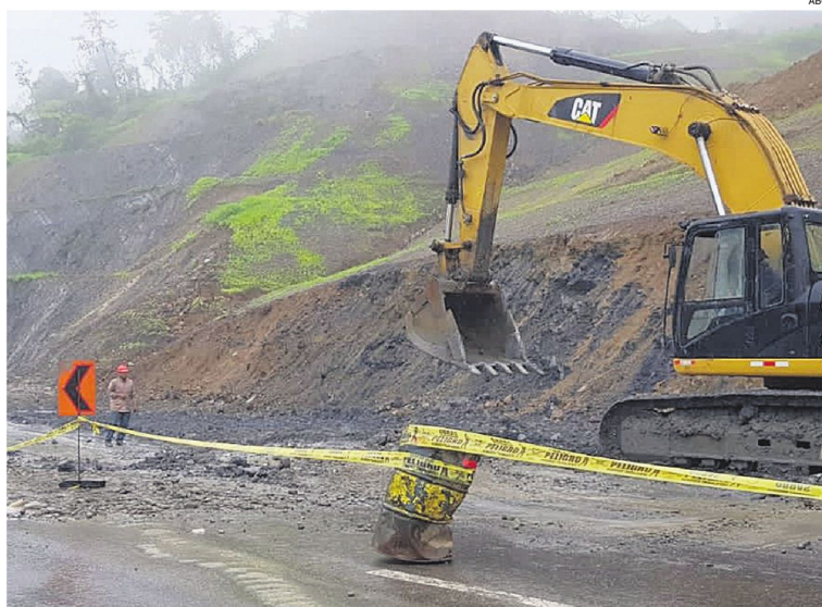
Maquinaria de la ABC en una parte del tramo El Sillar, afectada durante la época de lluvias.
