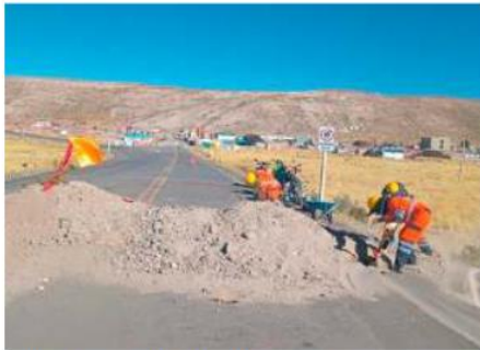
Trabajadores de la ABC levantan los escombros de una de las vías /ABC
