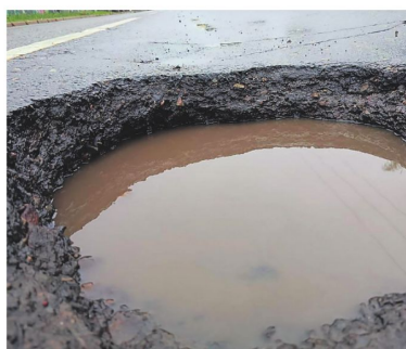
El hueco que afectaba a los conductores en el cuarto anillo y avenida Cristo Redentor fue arreglado
