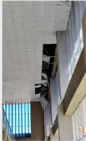
El lugar está abandonado, sucio y con evidente deterioro / LA PATRIA
