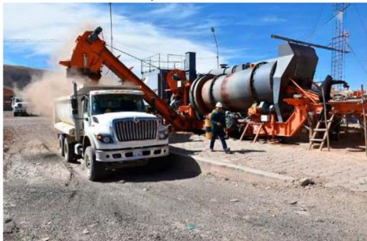
Planta de asfalto vuelve a quedar paralizada /GAMO
