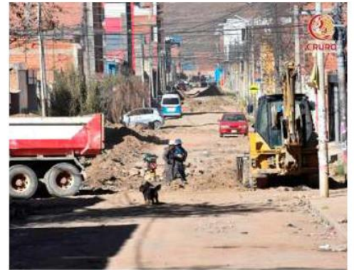
La obra está casi concluida. Falta la limpieza y dejar transitable la zona /GAMM
