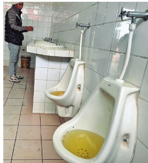
La orina se queda estancada en baños del colegio Luis Antonio Áñez
