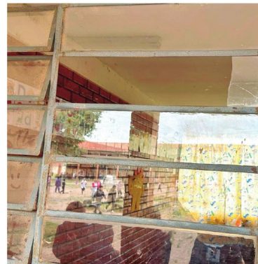
También se necesita cambiar los vidrios rotos
