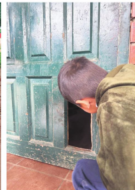
Algunas puertas están en mal estado
