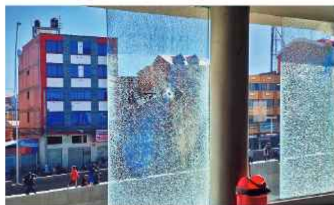
DESTROZO. Dos vidros, roto en la estación de la línea Azul.
