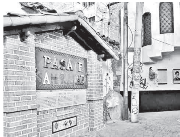
El letrero del pasaje en mal estado.
