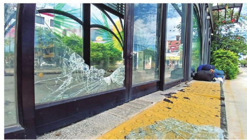
Tienen vidrios rotos y personas en situación de calle copan el espacio.
