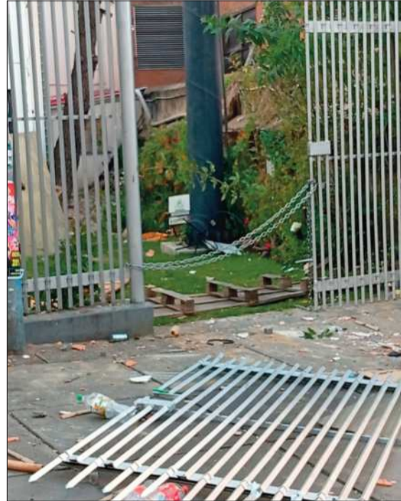
VANDALISMO. Así quedó una reja tras el ataque.
