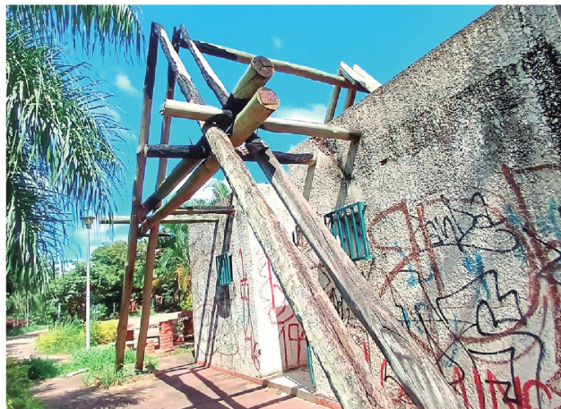
Paredes del baño son usadas para el pintarrajeo de las pandillas
