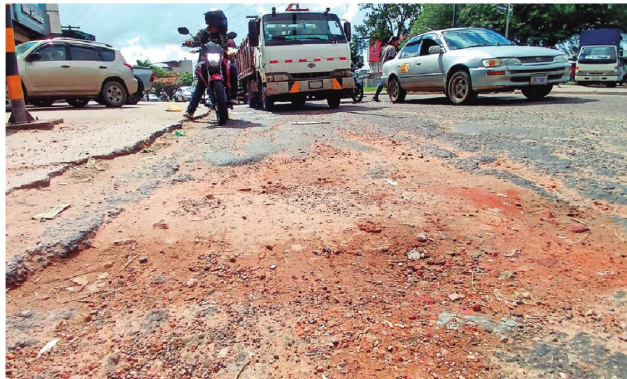
El estado del pavimento en la avenida Tres Pasos al Frente
