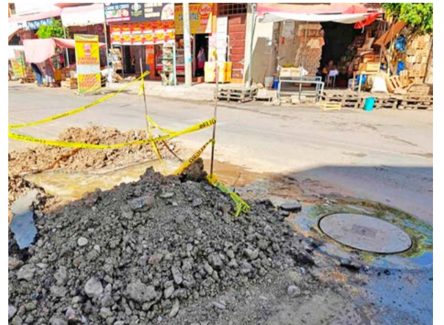
El colapso de aguas residuales del alcantarillado.
