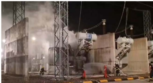
Incendio en la Subestación Carrasco / IYES
