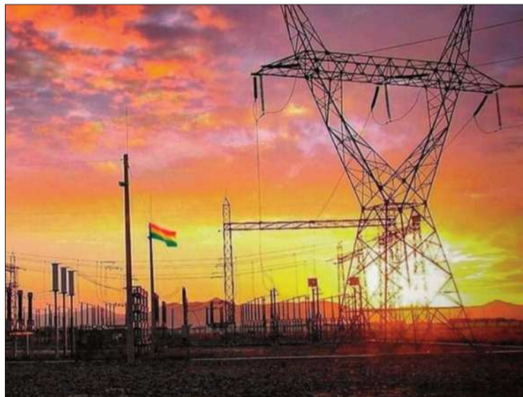
INFRAESTRUCTURA. Torres de interconexión eléctrica en el país.
