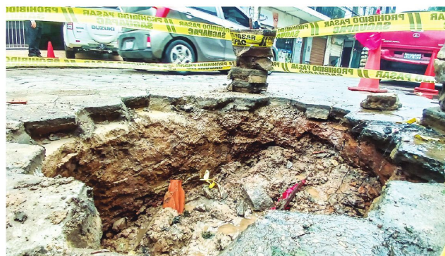
El hundimiento que se abrió en la calle Barrón. Saguapac acordonó el lugar
