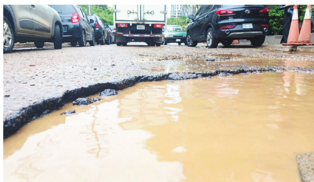
Varias calles necesitan mantenimiento en la zona de Equipetrol
