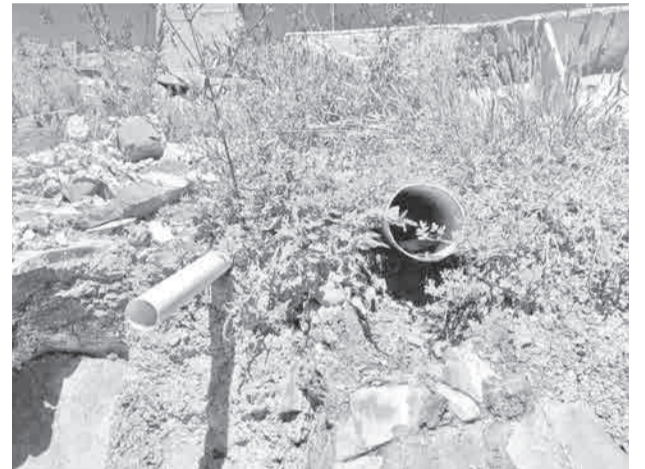
Tuberías expuestas por el deslizamiento. NELSON RAMOS
