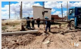
Los pozos servirán para mejorar distribución de agua potable en Oruro / SeLA
