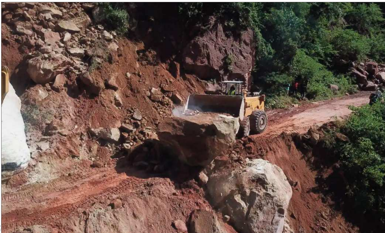
CARRETERAS. Varios tramos caarteros sufrieron derrumbes y se requirió de maquinaria pesada para remover los escombros y piedras.
