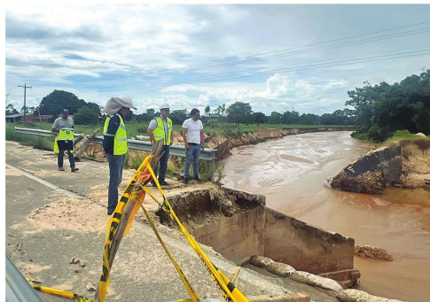
Personal de la ABC inspecciona un tramo dañado por las riadas
