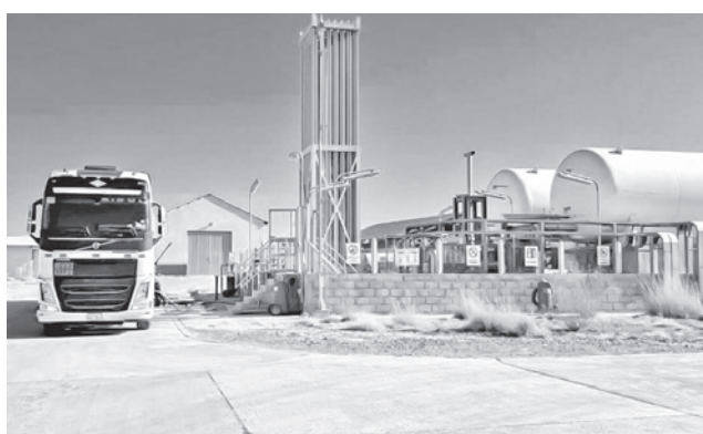
Una de las instalaciones de regasificación. YPFB
