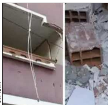
La explosión causó destrozos.
