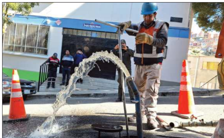
INSTALACIÓN. La ley establece la instalación de hidrantes estratégicos.
