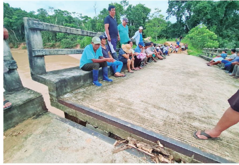
El puente que cedió por la fuerza del agua. Hay amenazas de bloqueo
