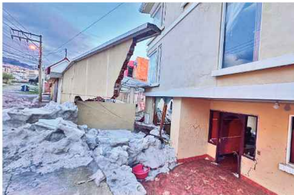
DESASTRE. Parte del edificio que colapsó por el peso del granizo, sucedió el domingo.
