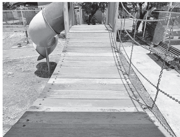
Mal estado de los juegos del parque.
