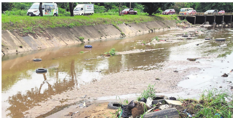
El agua arrastra llantas que quedan en medio del lodo del canal que está a metros de la Quinta Municipal
