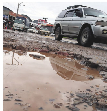
Hay vehículos que caen en estos tramos dañados
