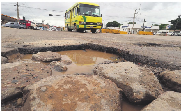
Los baches en la zona de la doble vía a La Guardia y octavo anillo
