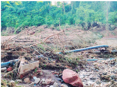
En la zona de Masicurí se dañaron las cañerías de la red de agua
