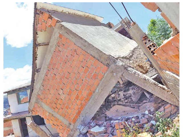
Los daños en las casas de Nuevo Amanecer.
