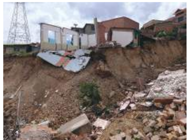
Los deslizamientos continúan en el barrio.
