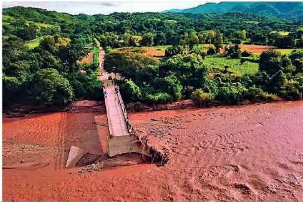
PLATAFORMA: Parte del puente arrastrado por las aguas del río El Bañado, en Monteagudo.
