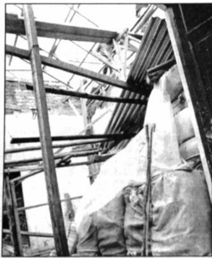
La lluvia causó estragos en los libros del Repositorio Nacional.
