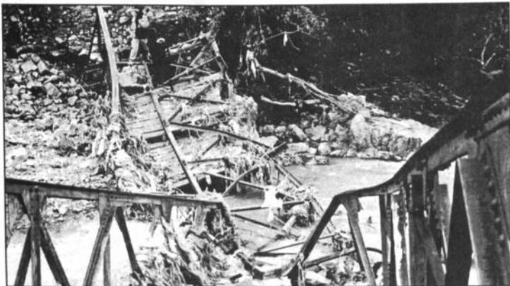
Hace algunas semanas, las torrenciales lluvias destruyeron hasta puentes metálicos en Sucre.
