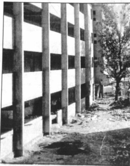
Las obras del nuevo hospital se dejaron a medias.
