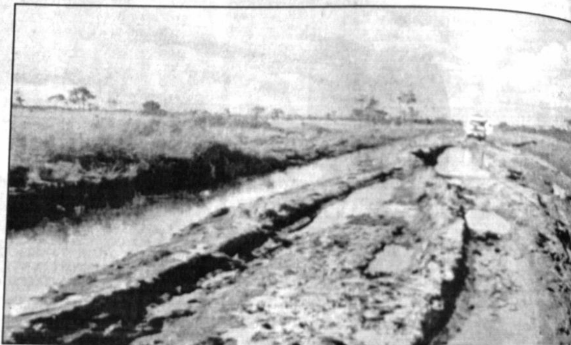
Camino en pésimo estado y ahora bloqueados.
